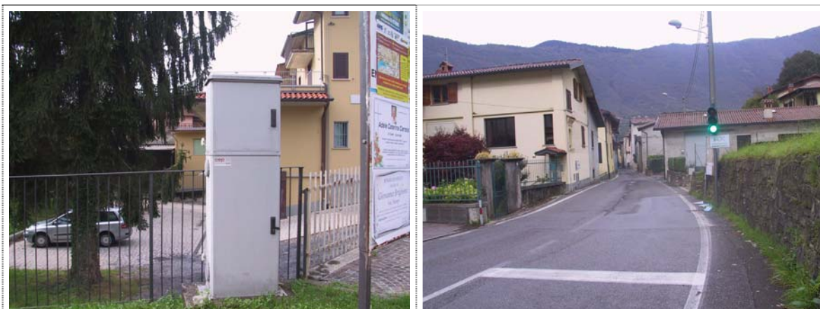
Foto 17: Quadro elettrico della rete di illuminazione pubblica ubicato in via S. Remigio.
