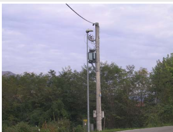
Foto 16: Cabina di trasformazione su palo ubicata in via Tironega.
