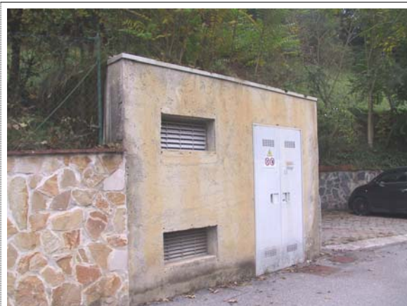
Foto 15: Cabina di trasformazione ubicata in via Repubblica.
