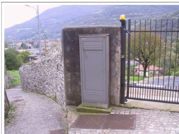
Foto 19: Armadietto di distribuzione della rete telefonica in Via S. Giorgio.
