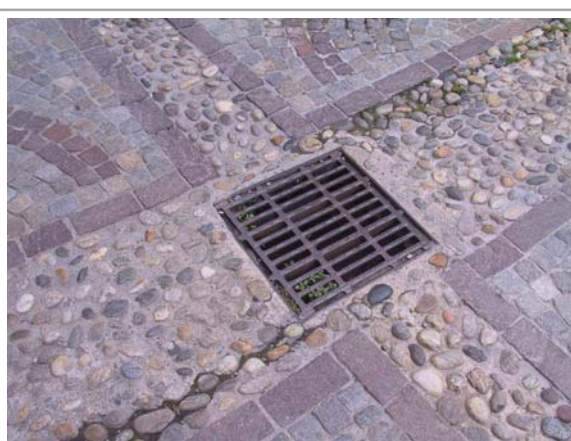
Foto 12: Caditoia per la raccolta e smaltimento delle acque meteoriche lungo via Martiri della Libertà.
