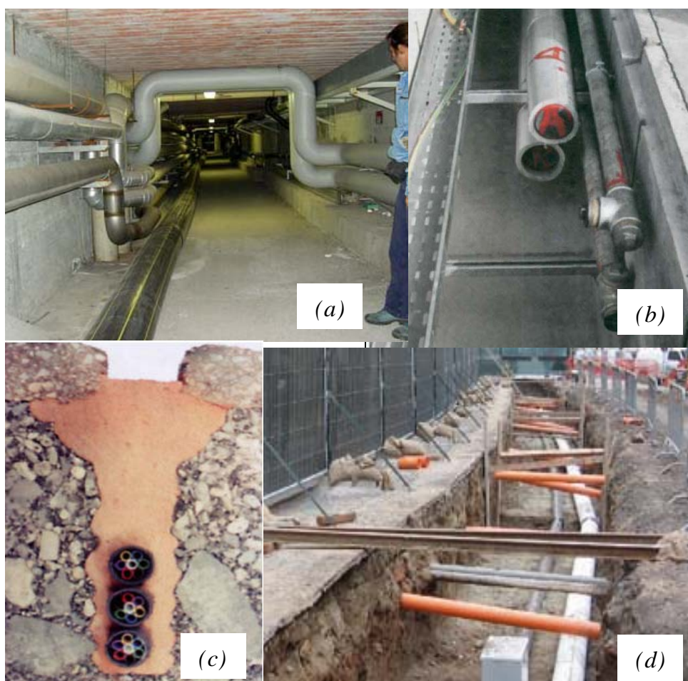
Figura 1: Galleria polifunzionale (a), cunicolo tecnologico (b), polifora (c) e trincea (d) (fonte: Regione Lombardia - Osservatorio Reti e Servizi di Pubblica Utilità)
