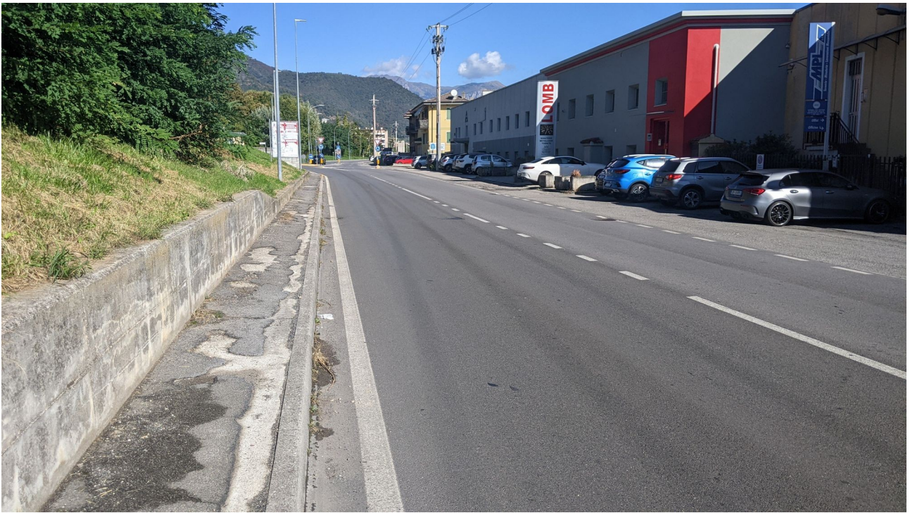
Fig. 17 Tratto stretto e ammalorato del marciapiede a ovest di via Nicolini; si prevede la riqualificazione e la realizzazione di un attraversamento sul lato opposto, dove sarà realizzata un nuovo tratto di pista
