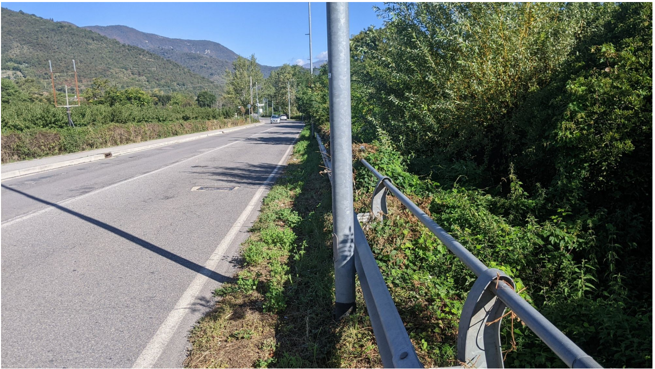
Fig. 15 Banchina esistente sul lato est di via Sorlini, oggetto di riqualificazione per la realizzazione della corsia ciclabile
