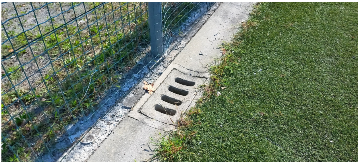
Vista raccolta canaletta perimetrale e recinzione ammalorate
