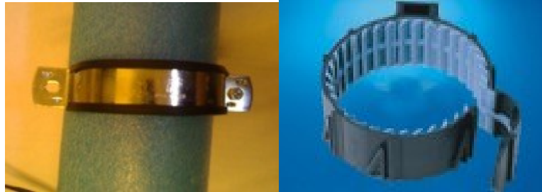
figura 9: colonna di scarico rivestita con collare antivibrante
