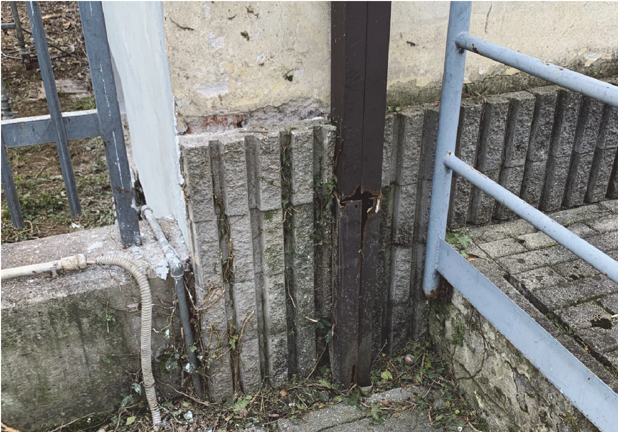
Pluviale ammalorato dalla corrosione e dalla precedente vegetazione eliminata
