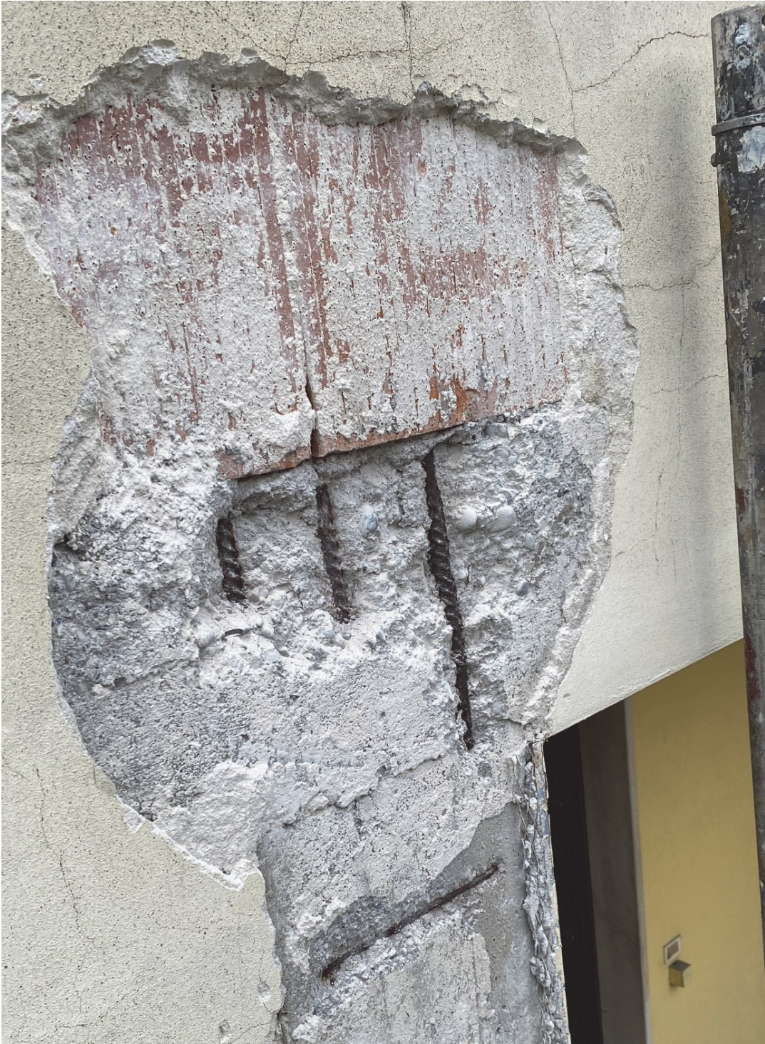
Distacco dell'intonaco e del copriferro
