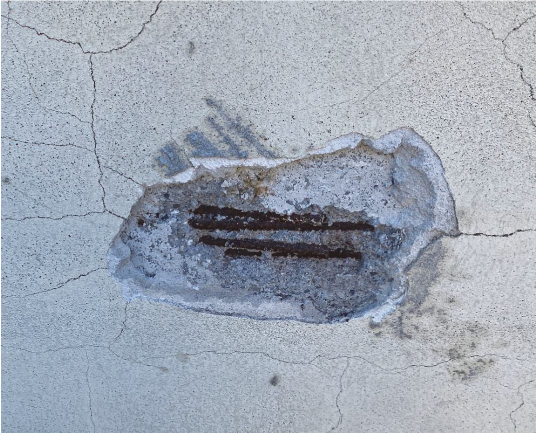
Distacco dell'intonaco e del copri ferro
