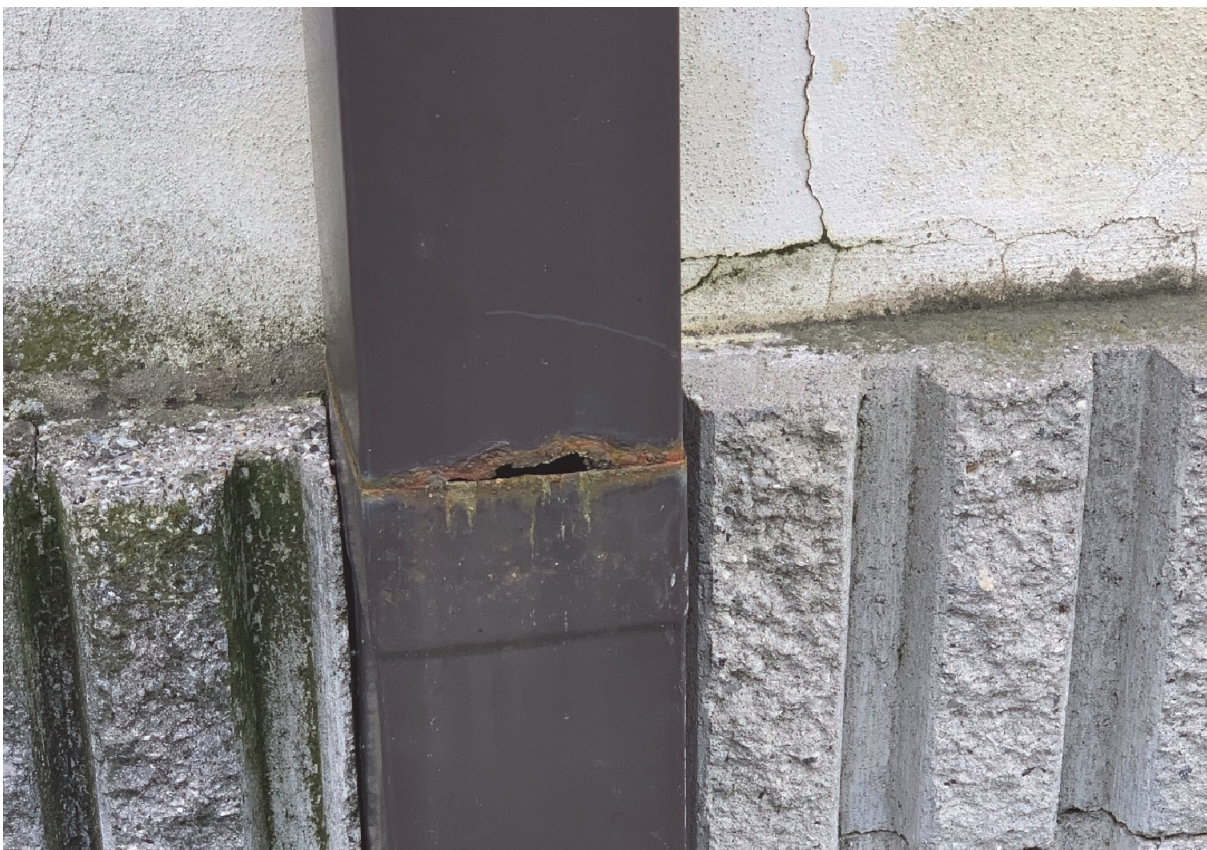
Pluviale ammalorato dalla corrosione
